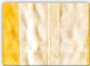
Ondulazioni vicino alle cuciture e saldature sul PVC
